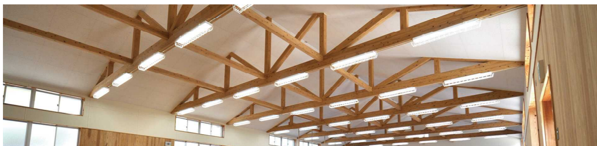
14mの武道場をキングポストトラスで飛ばした構造です。大分県産：杉無垢材使用
